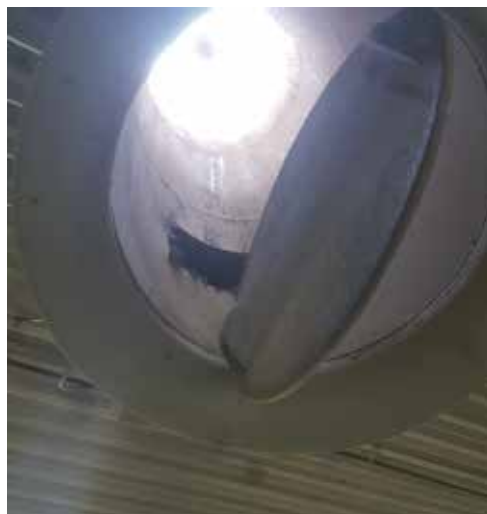
En fläkt som är placerad högt i en rengjord trumma ger en lägre ljudnivå i avdelningen.
