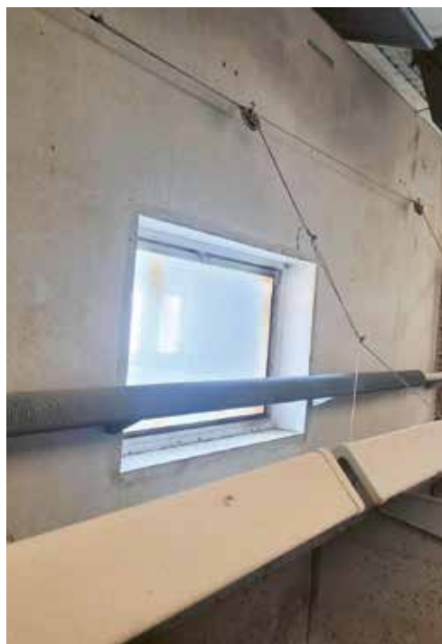
Kamflänsrör eller annan tillskottsvärme som placeras under luftintagen hjälper till att värma tilluften vilket motverkar kallras och hjälper till att transportera ut fukt. Foto: Kragsta Drift.
