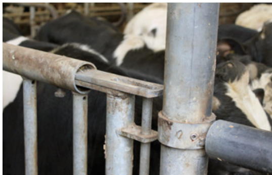
Ett plattjärn har svetsats på vid grindöppningen för att inte tjurarna ska kunna fastna med ett ben.
